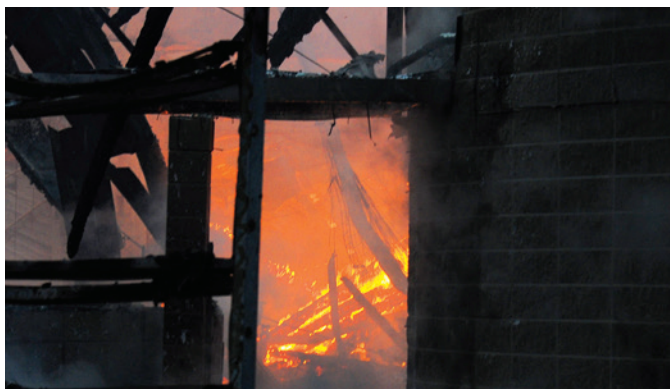
Parete in Lecablocco durante l'incendio. Le pareti in Lecablocco sono le uniche strutture rimaste intatte.
