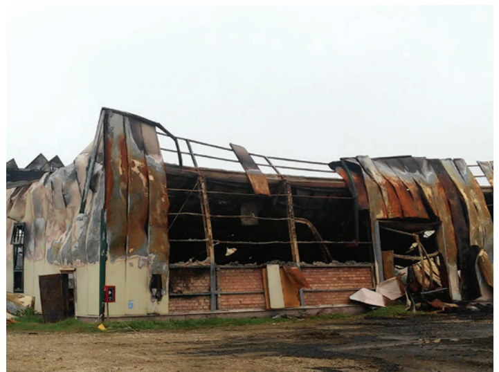
Stabilimento industriale con rivestimento metallico completamente distrutto in seguito ad un incendio.
