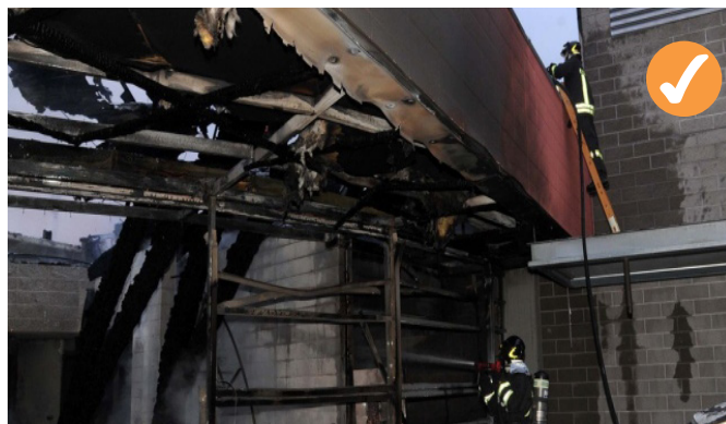
Fasi di spegnimento dell'incendio. Le pareti in Lecablocco Tagliafuoco perfettamente integre rendono più sicure le fasi di soccorso antincendio.
