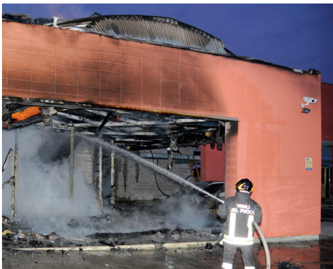
Edificio in Lecablocco dopo un incendio. Le pareti in Lecablocco sono rimaste perfettamente integre.
