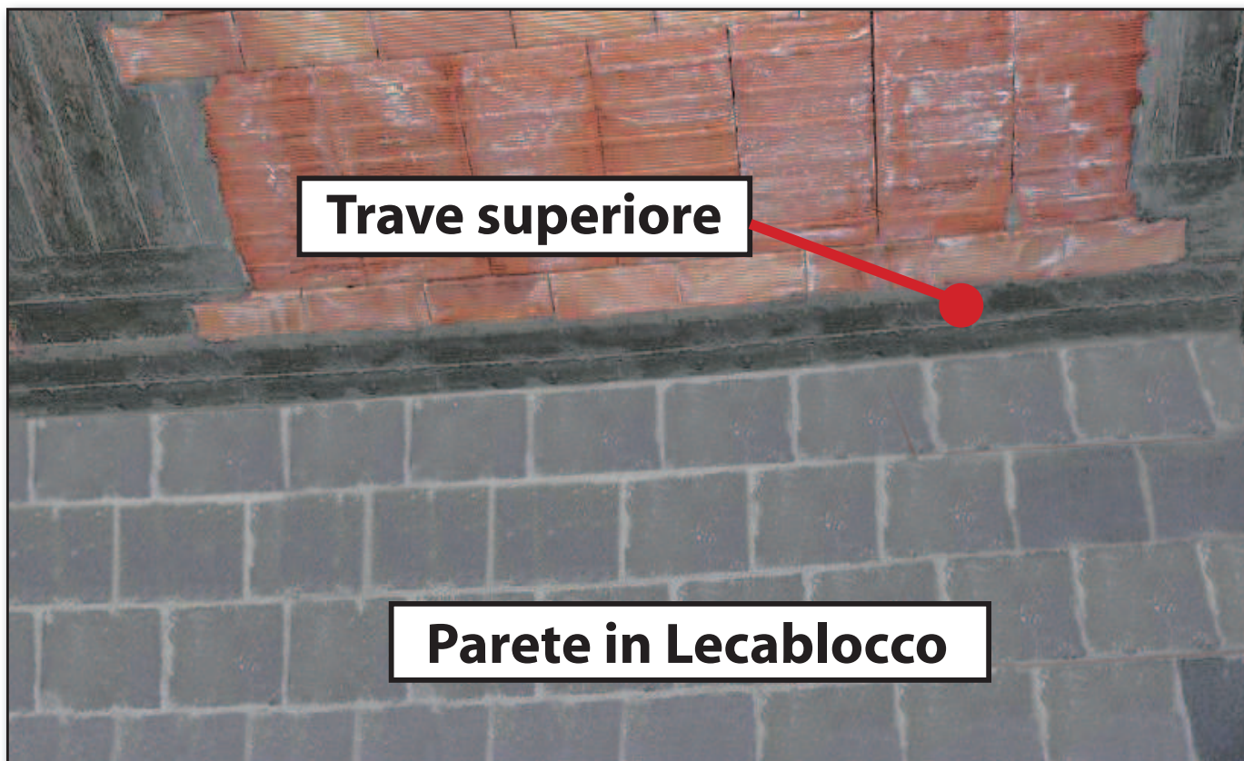
Foto 1 Nodo tra parete divisoria e solaio superiore.
