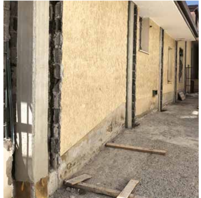
Rinforzo a pressoflessione mediante l'applicazione della rete PBO-Mesh 105, fissata alla testa e al piede del pilastro tramite il connettore a fiocco PBO-Joint e completata con un secondo strato di MX-PBO Calcestruzzo.
