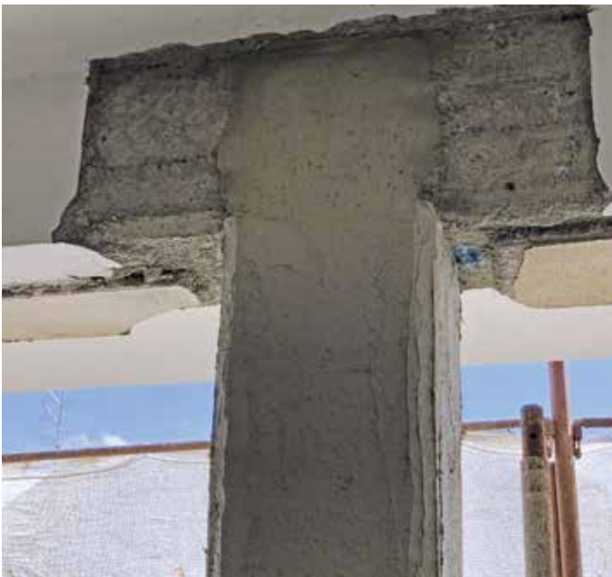
Ripristino del supporto con MX-R4 Ripristino, malta tixotropica fibrata per il ripristino del calcestruzzo e la preparazione del fondo.
