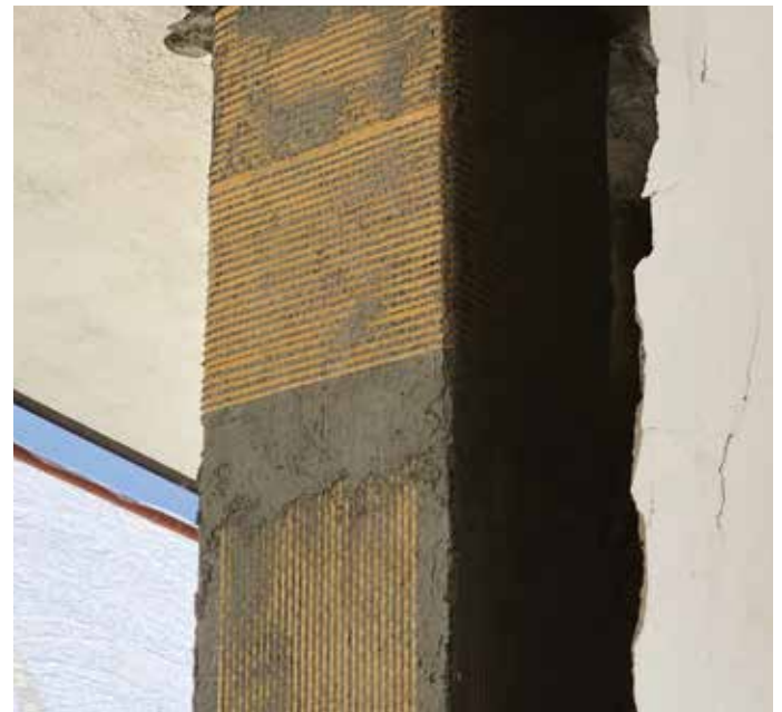
Rinforzo a pressoflessione, a taglio e confinamento dei pilastri: posa della rete PBO-Mesh 105 e della matrice inorganica MX-PBO Calcestruzzo.
