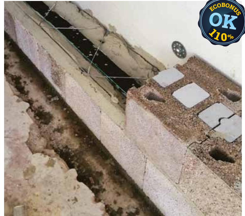
La parete in Lecablocco Bioclima Zero29T è stata posata con Malta Leca M5 Supertermica per ottimizzare il comportamento della parete, con striscia isolante e traliccio metallico.
