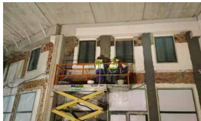
Posa del sistema FRCM mediante applicazione di matrice inorganica MX-PBO Muratura e rete PBO-Mesh.
