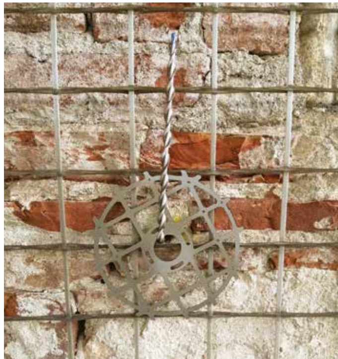
Sistema di Intonaco Armato CRM con rete Rete G-Mesh 490 per il consolidamento delle murature esistenti con Connettore Elicoidale innestato nella parete e G-Mesh Fazzoletto per la ripartizione delle concentrazioni di sforzo in corrispondenza delle connessioni.
